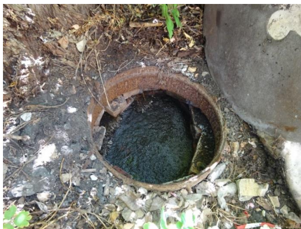
Рис. 2. Состояние канализационных колодцев
