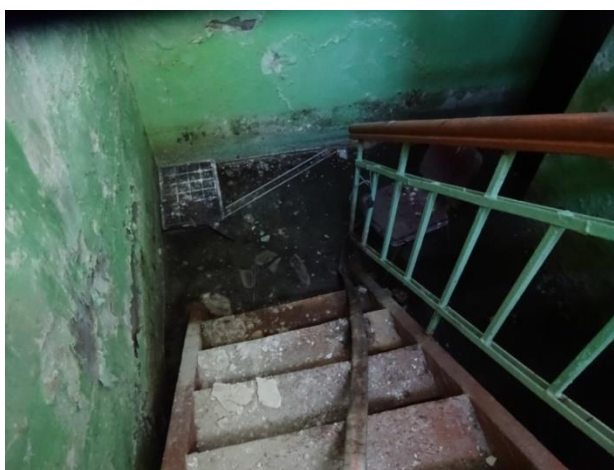
Рис. 1. Состояние подвала здания
