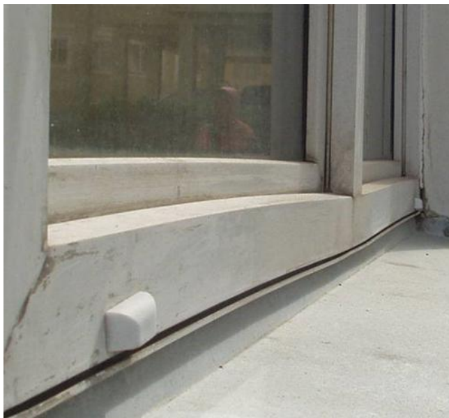
Рис. 6. Нарушение геометрии конструкции
