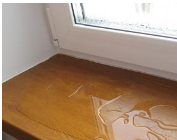
Рис. 7. Образование луж на подоконнике при задержке влаги из-за отсутствия дренажных отверстий
