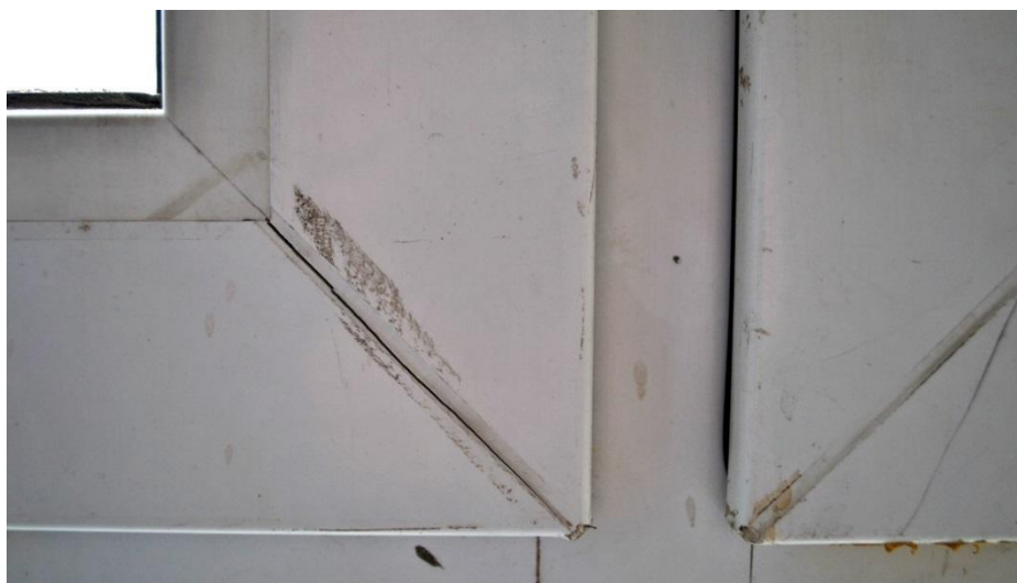
Рис. 8. Деформация сварного шва
