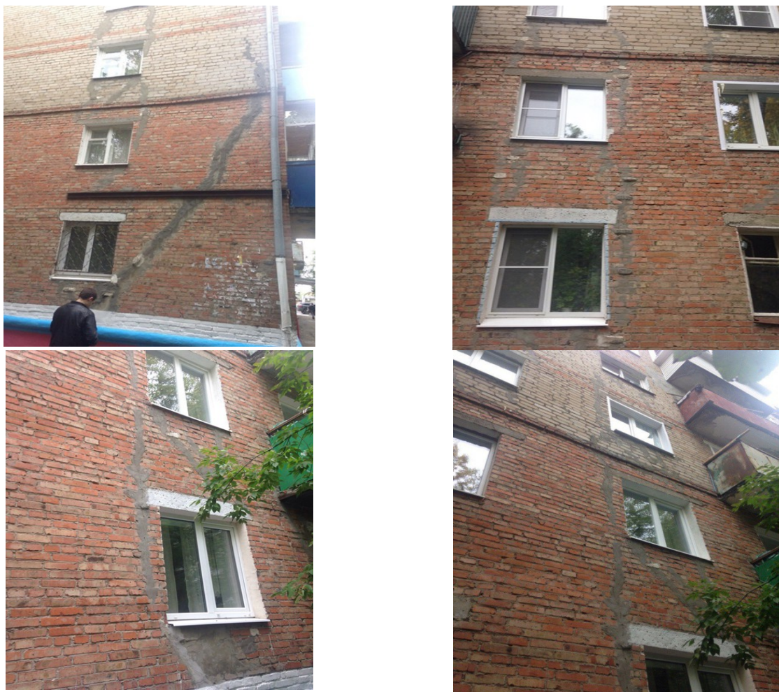
Рис.2. Трещины в кирпичных стенах из-за осадки здания
